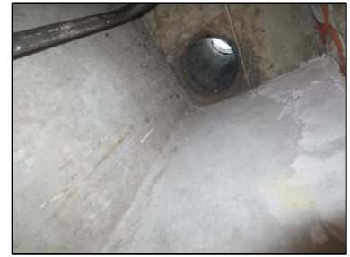
Photo N° 704 AMIANTE CIMENT 7 LORIENT--PLACARDS GAZ +8 Plafonds Ventilation haute (Fibres- ciment)
