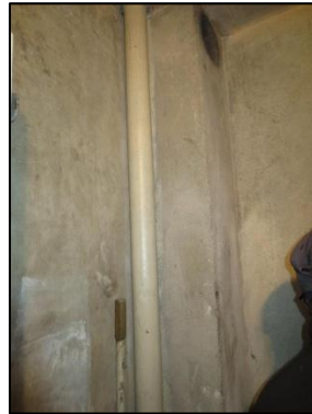
Photo N° 686 AMIANTE CIMENT 7 LORIENT--LOCAL V.O +7 à +8 Conduits de fluide Chute E.P.(Fibres- ciment)
